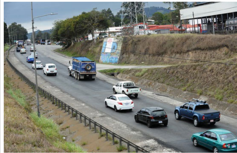
Los arreglos en la carretera que comunica San José con Cartago quedaron en suspenso hasta que la empresa encargada presente un nuevo diseño de los pavimentos. JORGE CASTILLO
