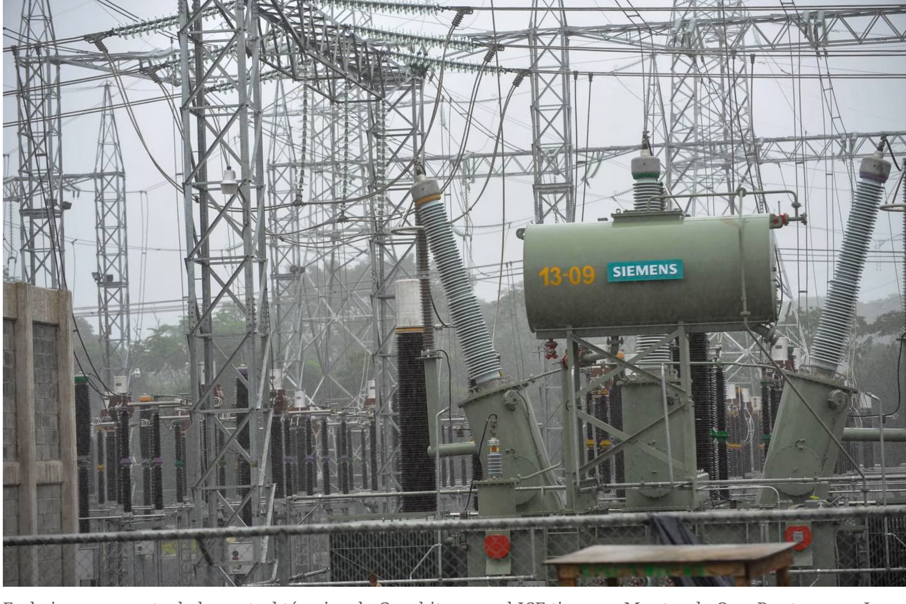
En la imagen, parte de la central térmica de Garabito, que el ICE tiene en Montes de Oro, Puntarenas. La generación térmica ha aumentado por consecuencia de la sequía. Foto: (Marvin Caravaca)
